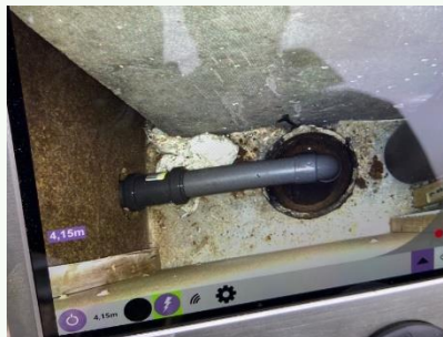
Ontbreken van standleiding, alternatieve afvoer keuken, standleiding staat rechts.
